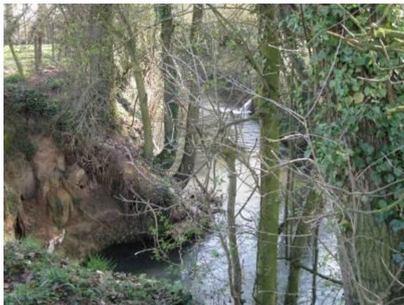
Erosion des berges
